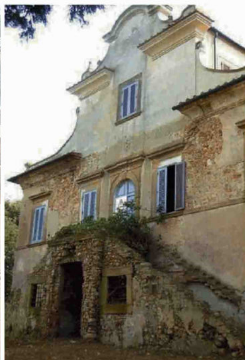
Villa Mirabella in condizioni di degrado
